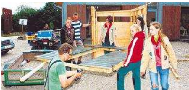
Die Jugendwerkstatt Förderband und die DPSG St. Peter und Paul zimmerten einen Wild-Beobachtungsstand. Foto: jea
